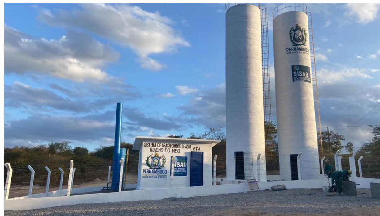
Sistema da comunidade Riacho do Meio, em Arcoverde/PE
