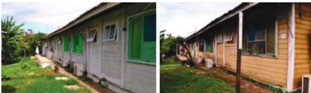
Hotel de Trânsito ANTES
